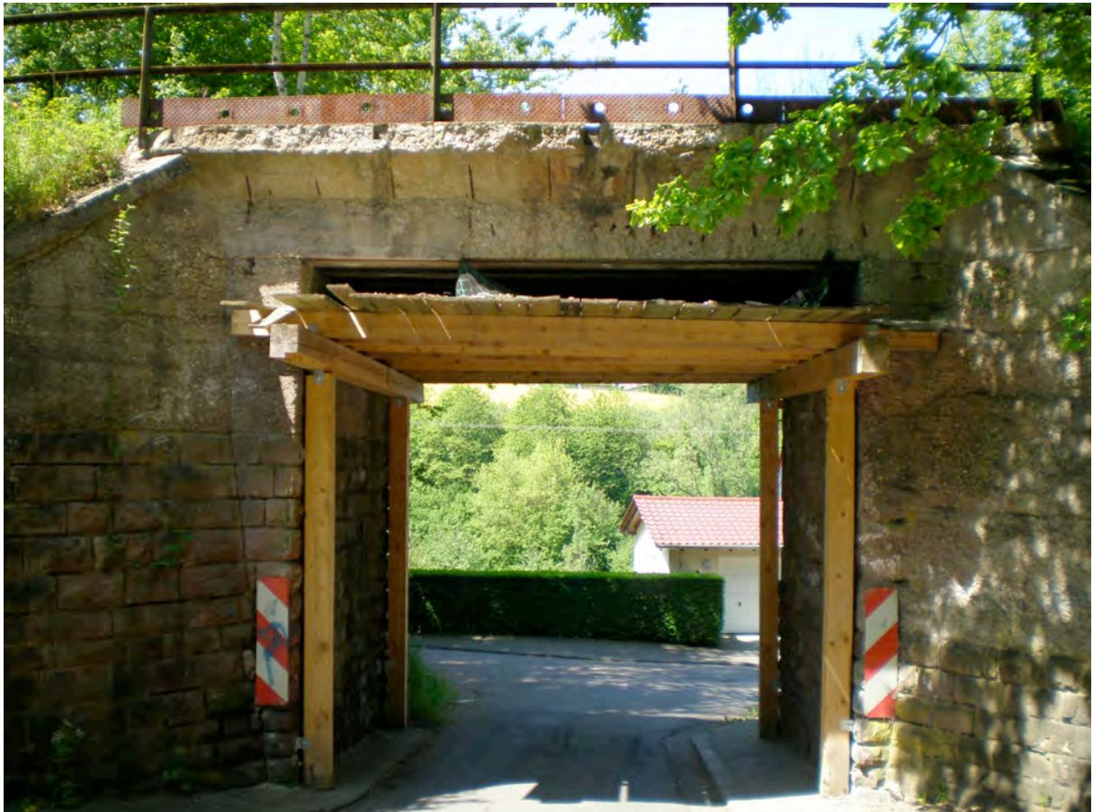
Bild 15: Brückenbauwerk in Eiweiler – wird saniert
